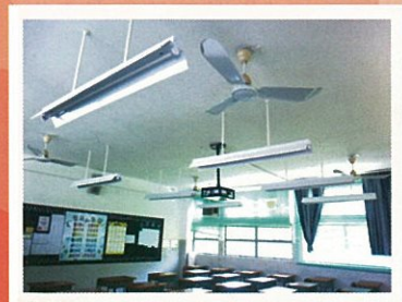
課室更換光管後的新貌
